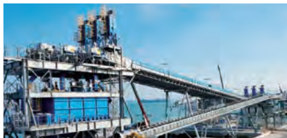
穀物搬入用ベルトコンベヤ (穀物搬送用 能力:1200 t/h)
